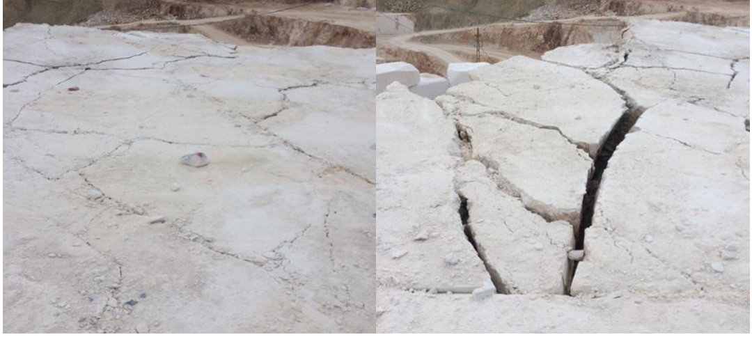
Şekil 4.13. Gevşetme sonrası yüzeyde oluşan çatlaklar
