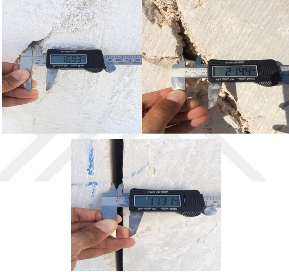
Şekil 4.19. Gevşetme öncesi ve sonrası piroteknik kaya kırıcının kullanılmadığı bölgelerdeki çatlak kontrolü
